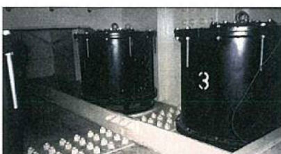
図9 歩道橋桁内に設置された TMD
